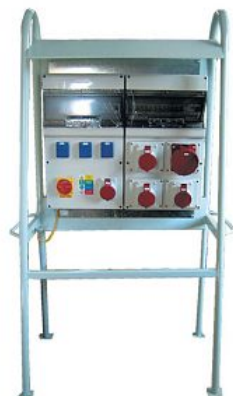
velké rozvaděče DST
